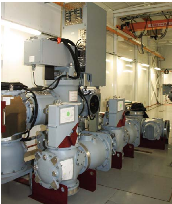
À l'intérieur du shelter : une usine électrique
